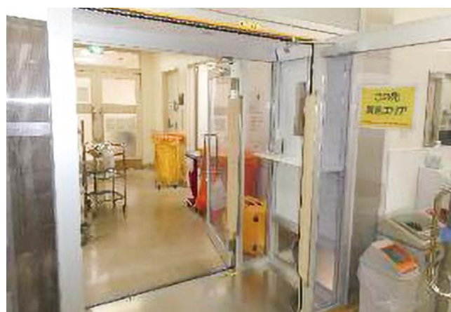
救命救急センター 陰圧装置
